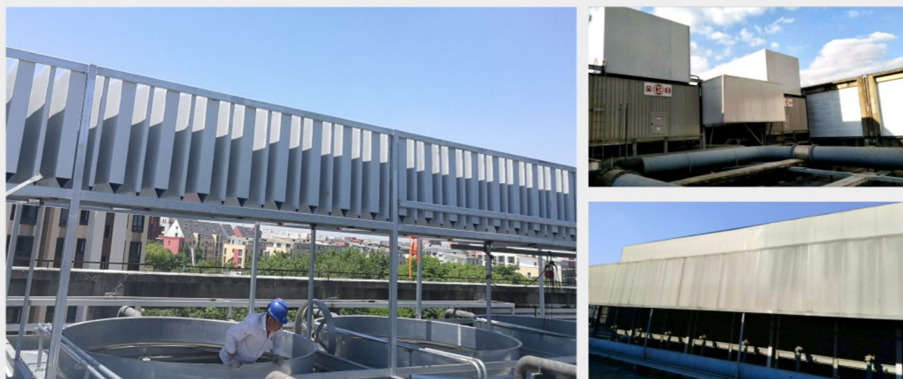
上海嘉定万科地产冷却塔降噪工程
