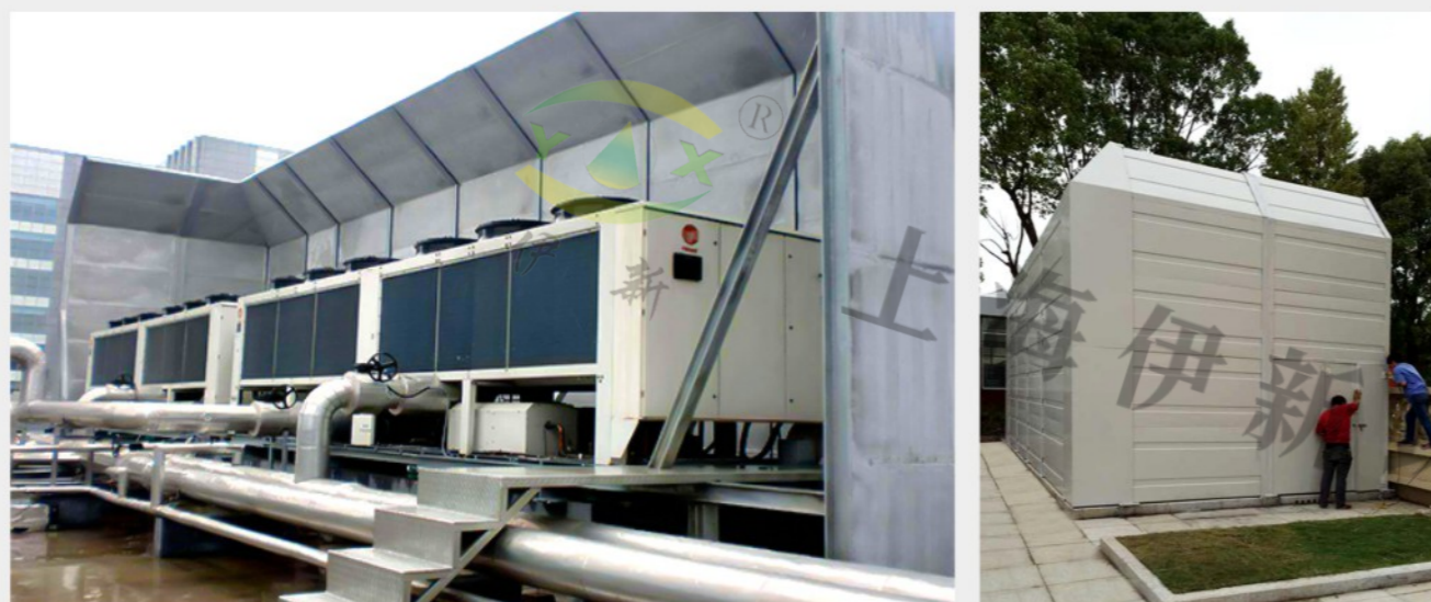
上海第六人民医院空调设备降噪工程
