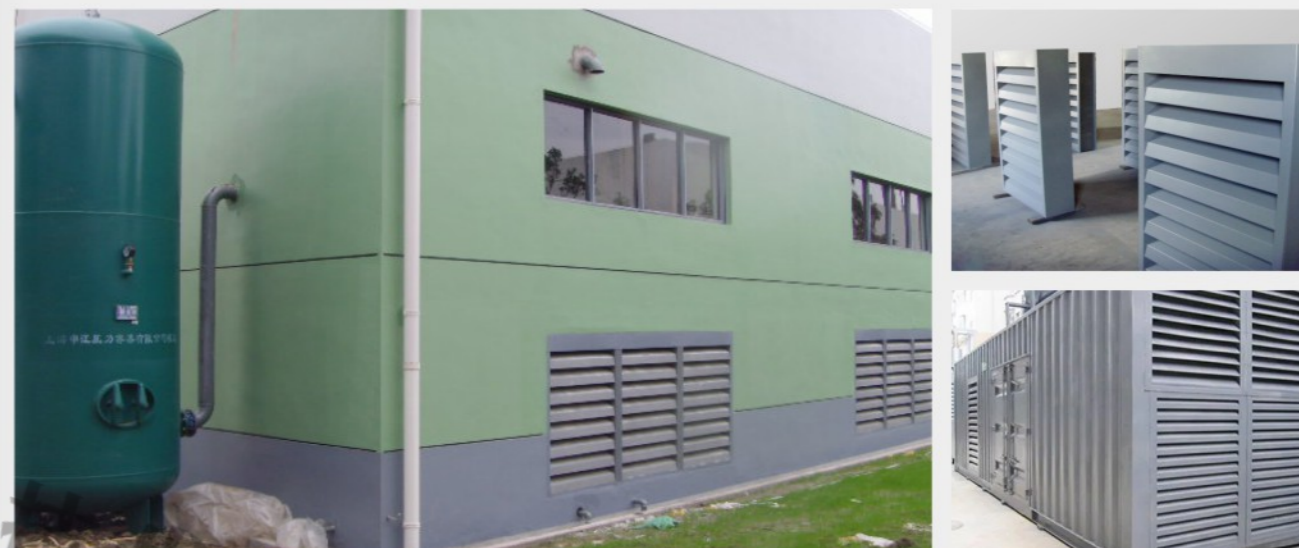
上海电气嘉定厂区设备降噪项目
